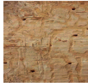
> Ovale Einbohrlöcher des Bockkäfers.
