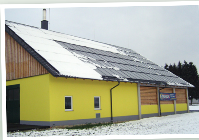
Im Sommer sorgt die thermische Solaranlage für Warmwasser, im Winter übernimmt die Biomasse diese Funktion.
