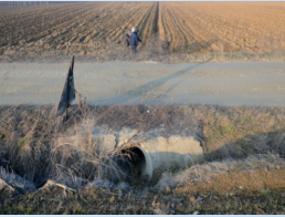
Direkter Gewässeranschluss über Abläufe (Wege/Rohre)
