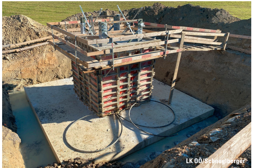
Für Kritik sorgen die großen unterirdischen Fundamenteinbauten, weil diese aus den bisherigen Unterlagen für die Grundeigentümer nicht ersichtlich waren
