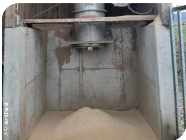
Abb. 131: Strohmatic Air – Entstaubung
